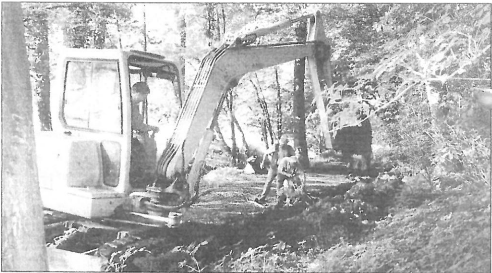
Im Ölbachtal wurde vom VVV Bergisch Neukirchen im Interesse der Wanderer mit Unterstützung der Fa. Flocke eine Drainageleitung verlegt.
